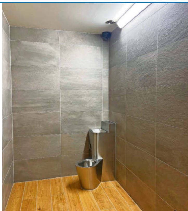
Die WC-Anlage im Isolationszimmer kann nicht mit Wasser geflutet werden.
